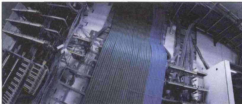
Interno del Pop di Bari. All'interno di un sito tecnologico si possono trovare anche migliaia di chilometri di cavi
